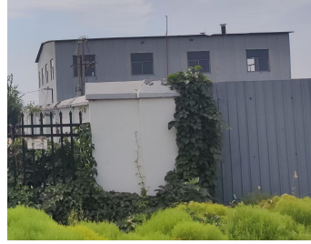
双增小区供热站
